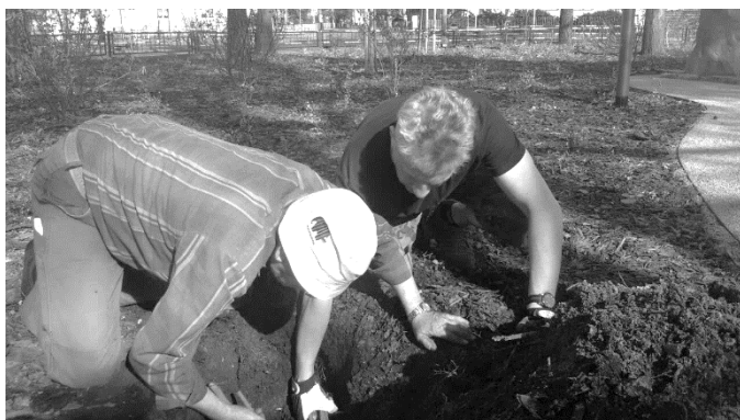
Rohrbruch im Pionierpark
